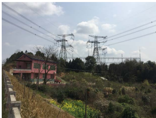
艾家冲 500kV 变出线构架
