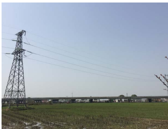
跨越220kV迎天线
