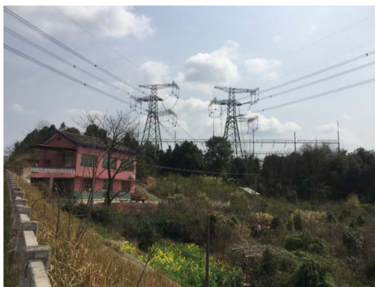
艾家冲 500kV 变出线构架
