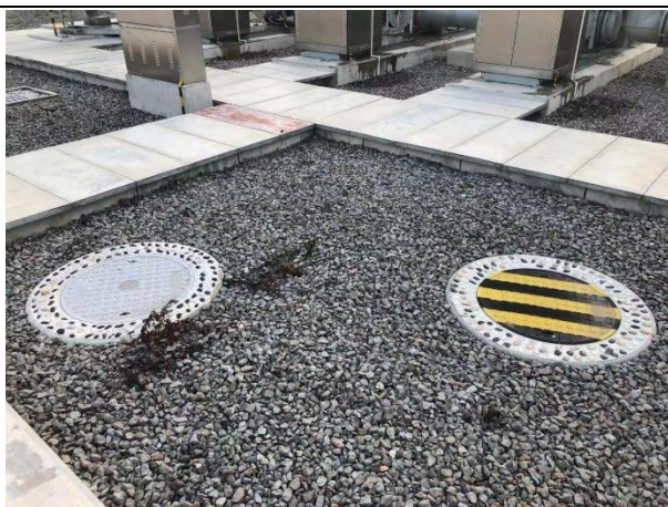
站内事故油池
