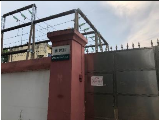
酿溪 110kV 变电站大门
